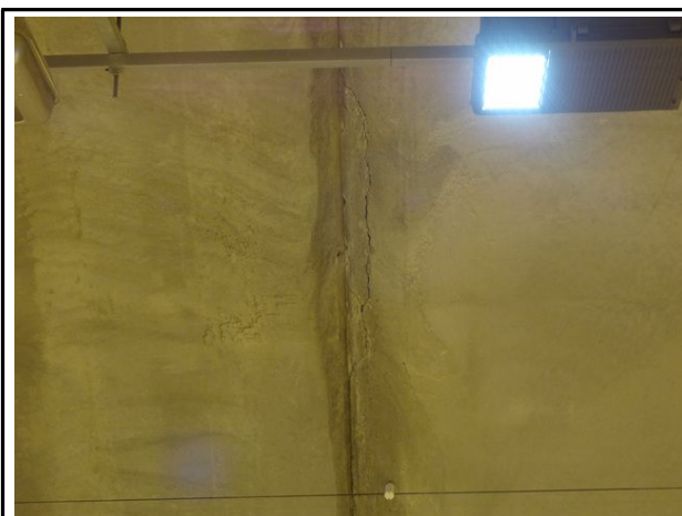
천단부 J5 조인트부 콘크리트 들뜸
