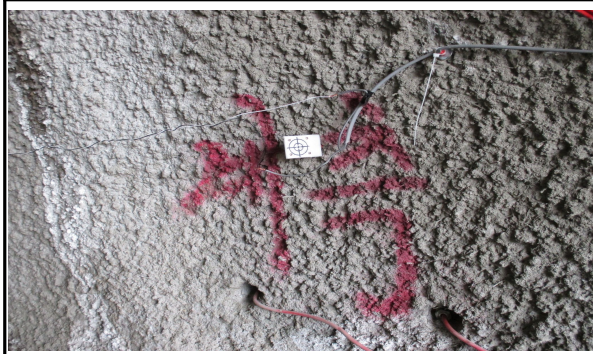
매봉터널 계측기 설치 상태(서울방향)
