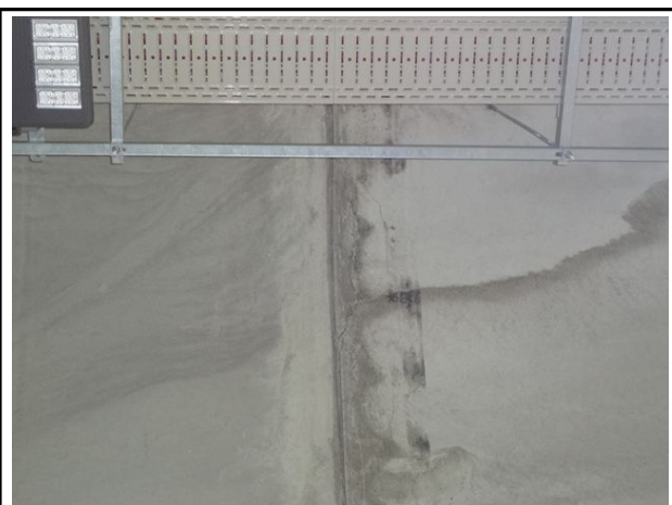
천단부 J33 조인트부 콘크리트 들뜸
